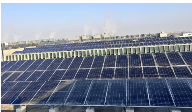
北京房山数据中心将太阳能光伏发电系统
