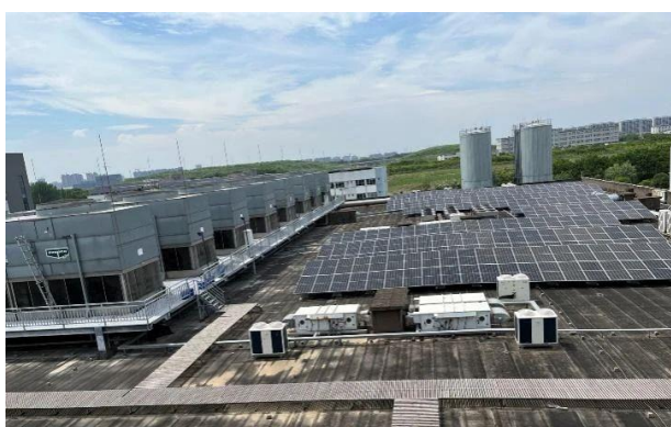
上海嘉定数据中心将太阳能光伏发电系统
