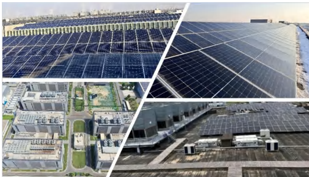
公司投建的光伏系统
